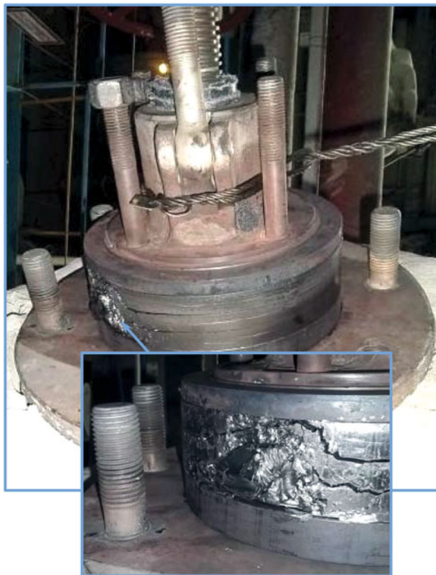
Разрушение колец ТРГ в узле “плавающая крышка”
